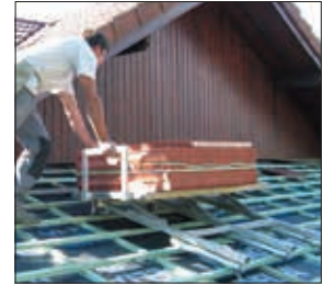
Platforma dachowa ZM
